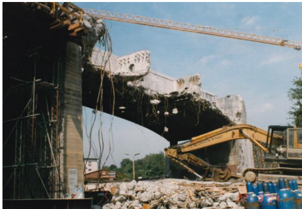
Abbildung 114 Der zum Teil abgebrochene Trägerbereich vor dem Bruch
