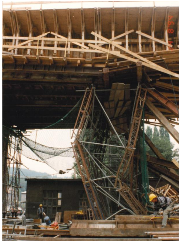
Abbildung 116 Schaden am erstellten Lehrgerüst
