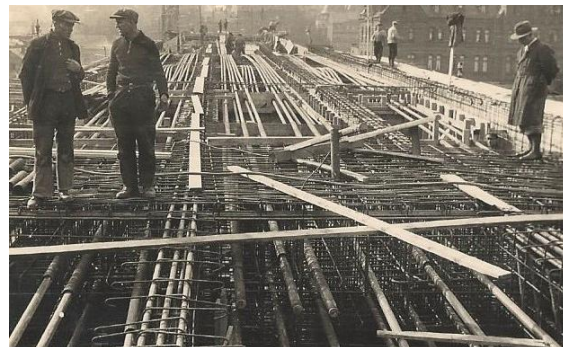
Abbildung 65 Ankerbereich der Spannglieder 05.10.1936
