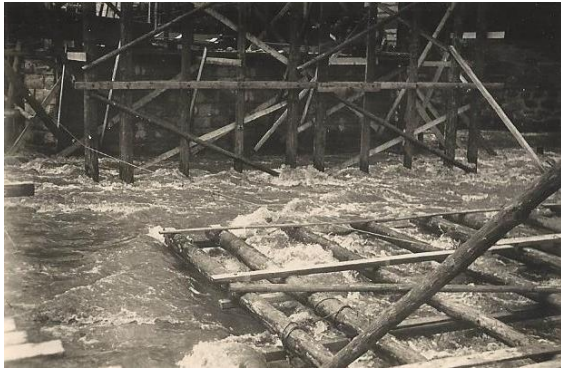
Abbildung 24 Hochwasser, Lehrgerüst Bauteil B am 3.07.1936 (Foto Herr Dipl.-Ing. Ring)
